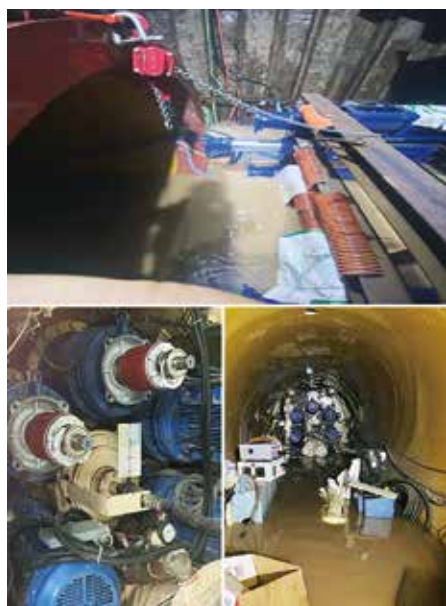
写真-8 水没状況と復旧作業
