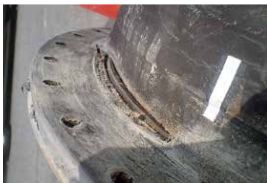
写真-7 破損したピンチバルブのゴム
