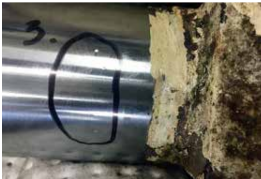
写真-12 ジャッキのロッドに傷がついた箇所
