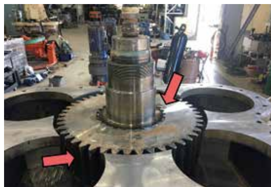
写真-10 センタシャフトとギヤケース
